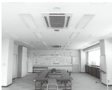
保健センター健康教育室空調設備(現況写真)
