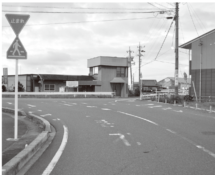
消えている道路標示の一部
