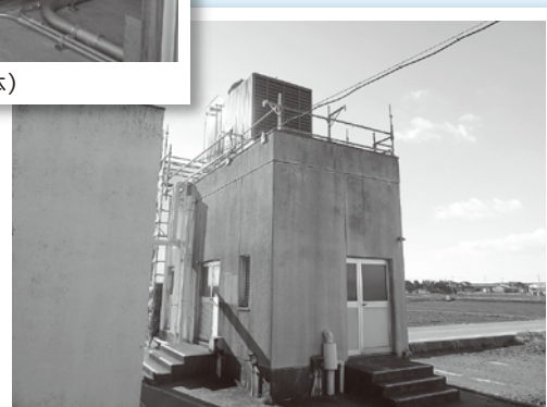
新しい冷却塔(屋上部分)
