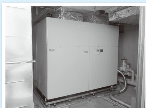
新しい空調機(本体)
