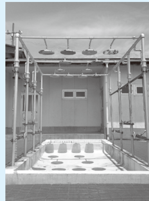
小学校プールシャワー
